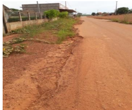
Processo erosivo dos cursos de água da chuva em área urbana. Degradação do asfalto no Bairro Paineiras Cacoal/RO.
