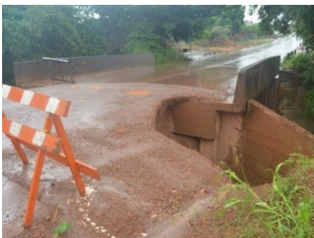
Processo erosivo na cabeceira de rio em Cacoal/RO
