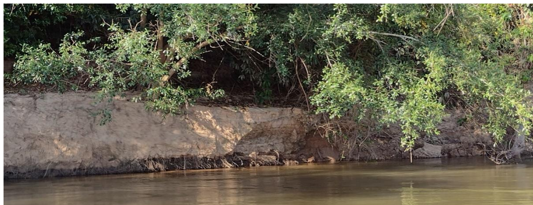
Figura 2 – Processo erosivo às margens do Rio Machado em Cacoal/RO.
